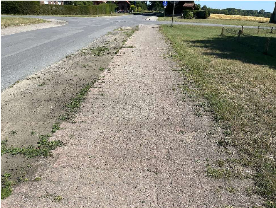
Abbildung 33: Verbesserungswürdig: Gemeinsamer Geh- und Radweg, Pflasterbelag in schlechtem Zustand, zu schmal für Begegnungsverkehr (Beispiel: Vinner Kirchweg, Ortsteil Herßum)
